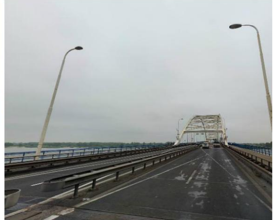
Foto 4: Overzicht bovenzijde kunstwerk.
